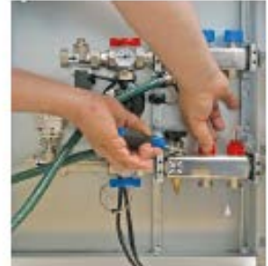
4. Plombierkappen abziehen und alle Durchflussmengenmesser öffnen.
